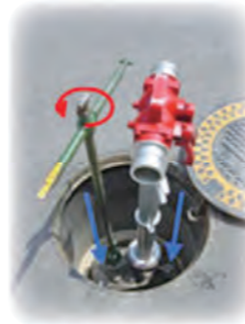
スタンドパイプ
