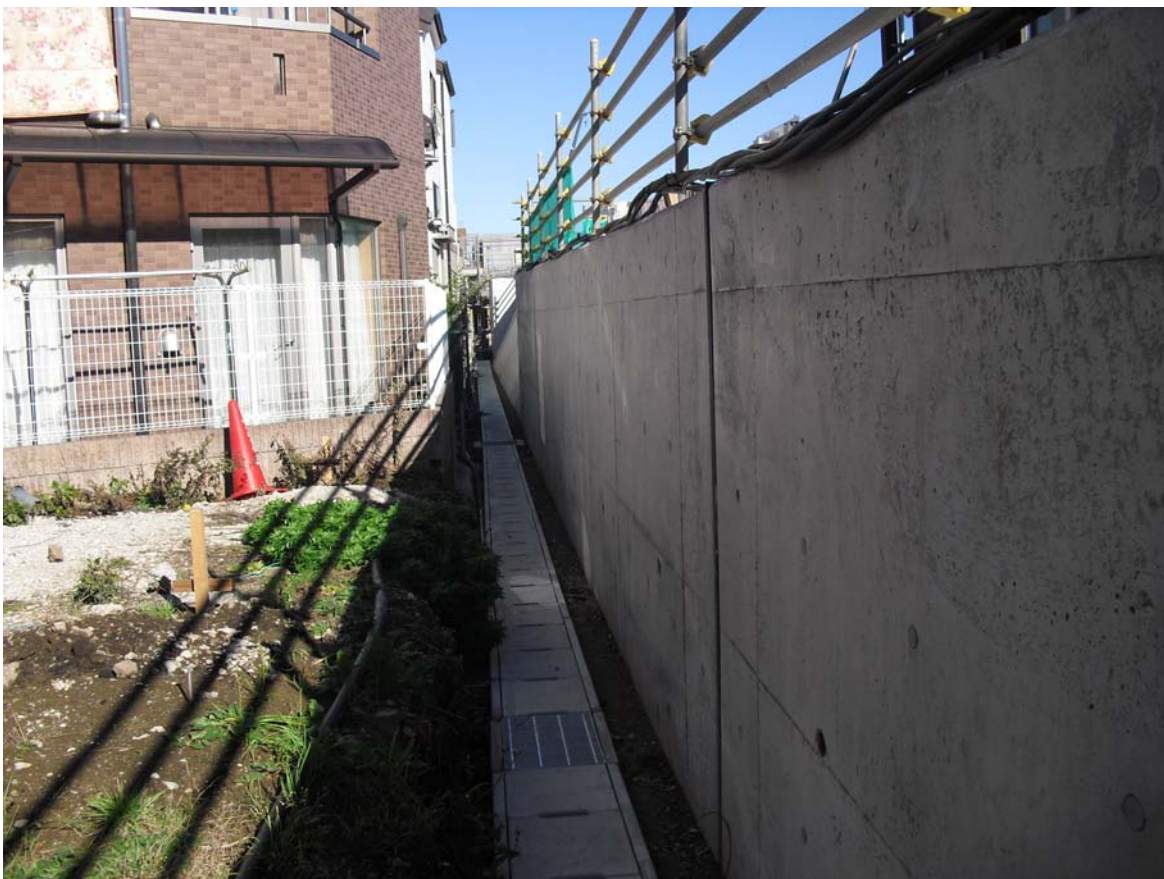
写真8 東北沢4号踏切～東北沢3号踏切 北側の擁壁（高さ2m程度）
